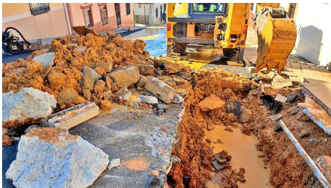
Tubería de agua en Puertollano Ayuntamiento
