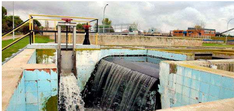
Anuncian la esperada renovación de la depuradora del Polígono. / DAVID PÉREZ
